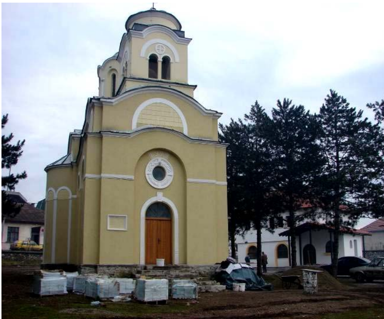
Поглед на западни део обновљеног храма, у позадини иза борова види се нови обновљени парохијски дом, јануар 2008. год.
